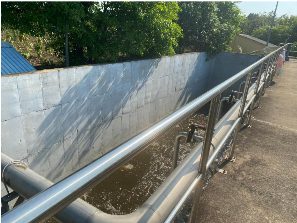
Bể điều hoà
