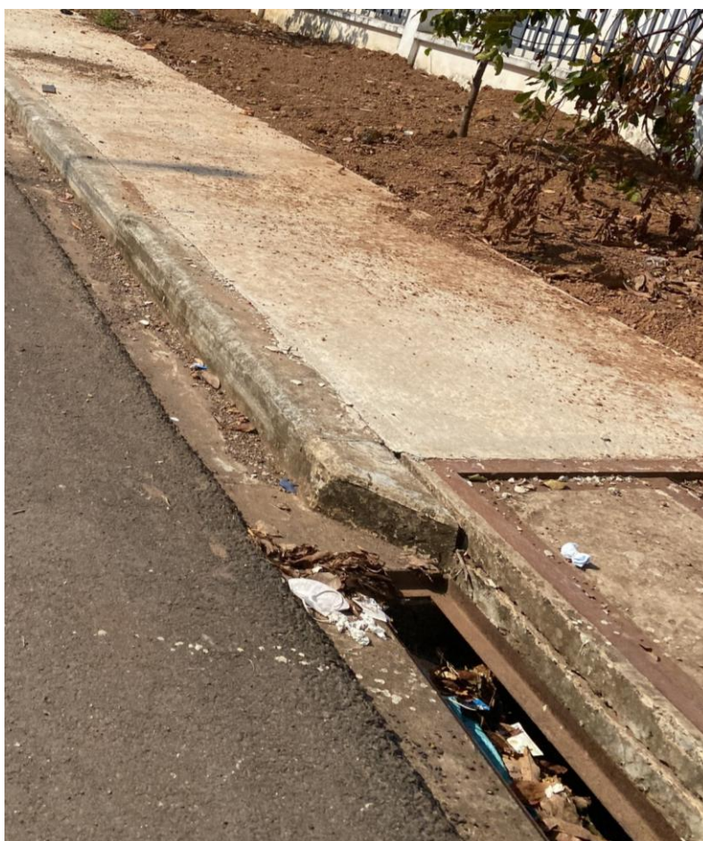
Mương thu gom nước mưa KCN
