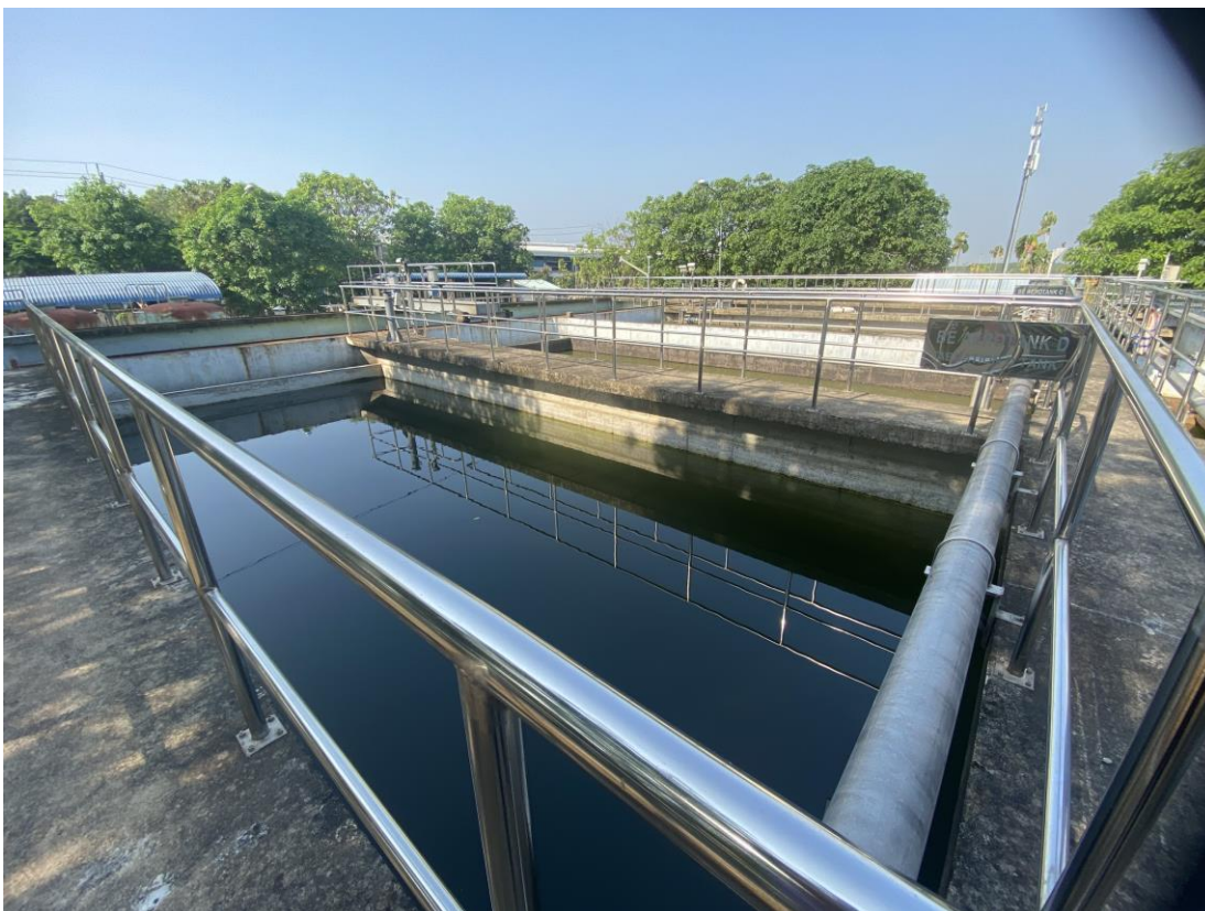
Bể aerotank (D) (hiện nay chưa lắp thiết bị)
