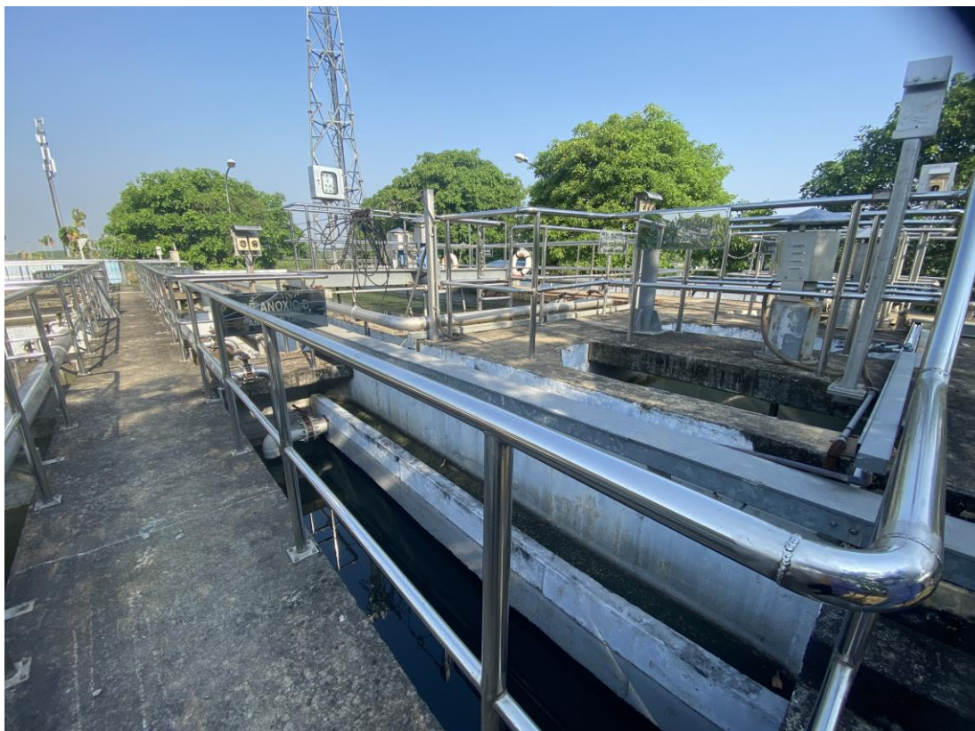
Bể anoxic (D) (hiện nay chưa lắp thiết bị)
